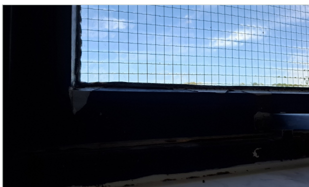
H Raamkozijn: opnieuw schilderen en rondom volledig opnieuw afkitten.
